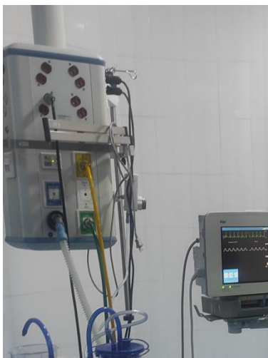
Fotografía N. 12 Narváez E. (2025). Torres con tomas de electricidad para reducción de riesgo eléctrico.
